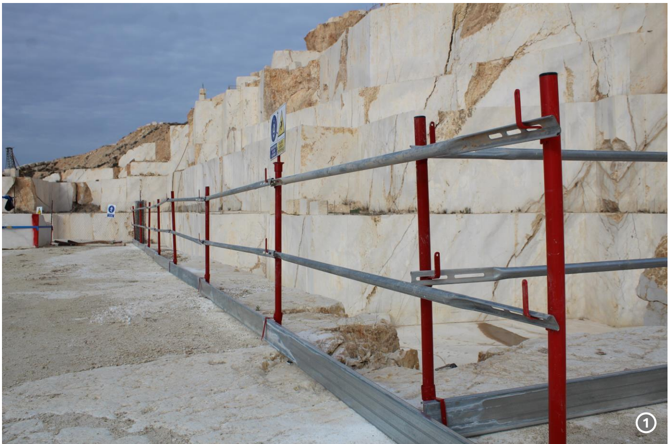
1. Ejemplo de barandillas provisionales en explotación de roca ornamental.
