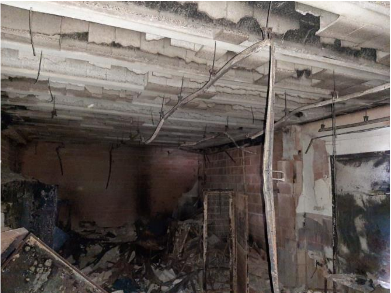
*Estructura afectada por incendio (fuente en bibliografía)
