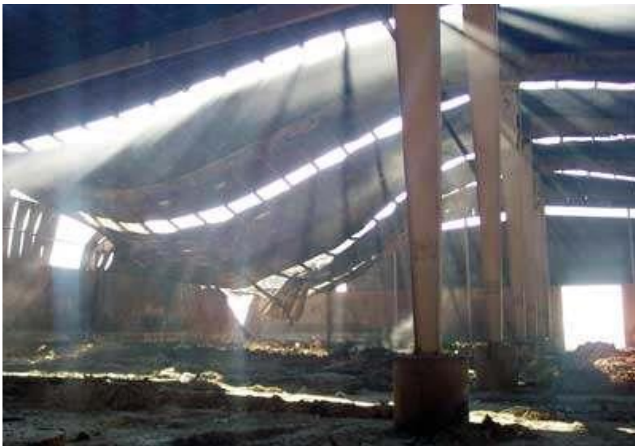
*Estructura afectada por incendio (fuente en bibliografía)
